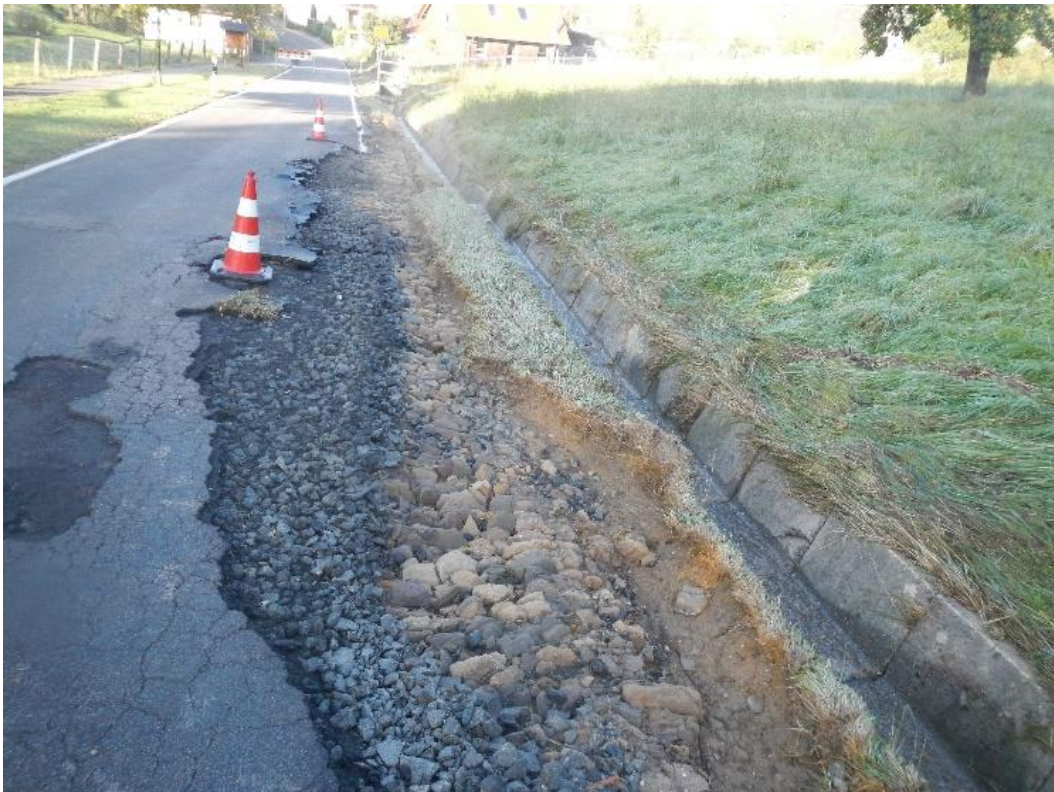
Abbildung 59: Durch Starkregen unterspülte Straße (Beispielbild)
