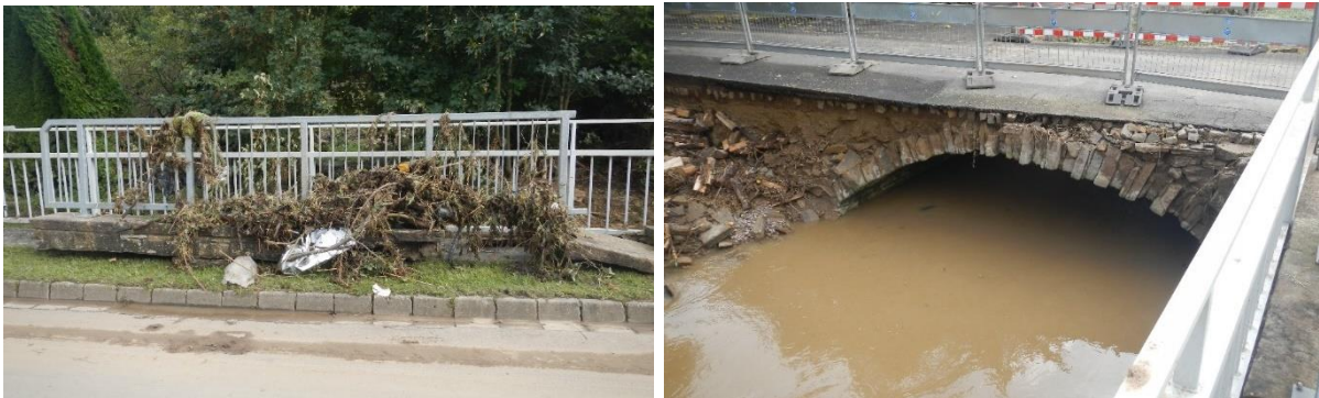
Abbildung 55: Treibgut und zerstörtes Brückengeländer infolge Wasserdrucks (Beispielbilder)
